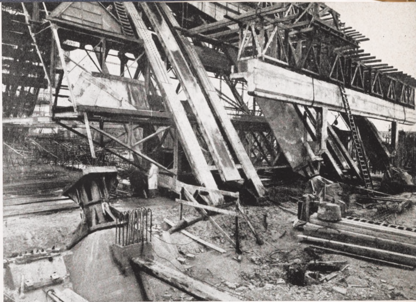
Fig. 111. Ripage du cintre. Le cintre est posé sur ses chariots de roulement et le ripage est en cours d'exécution.
